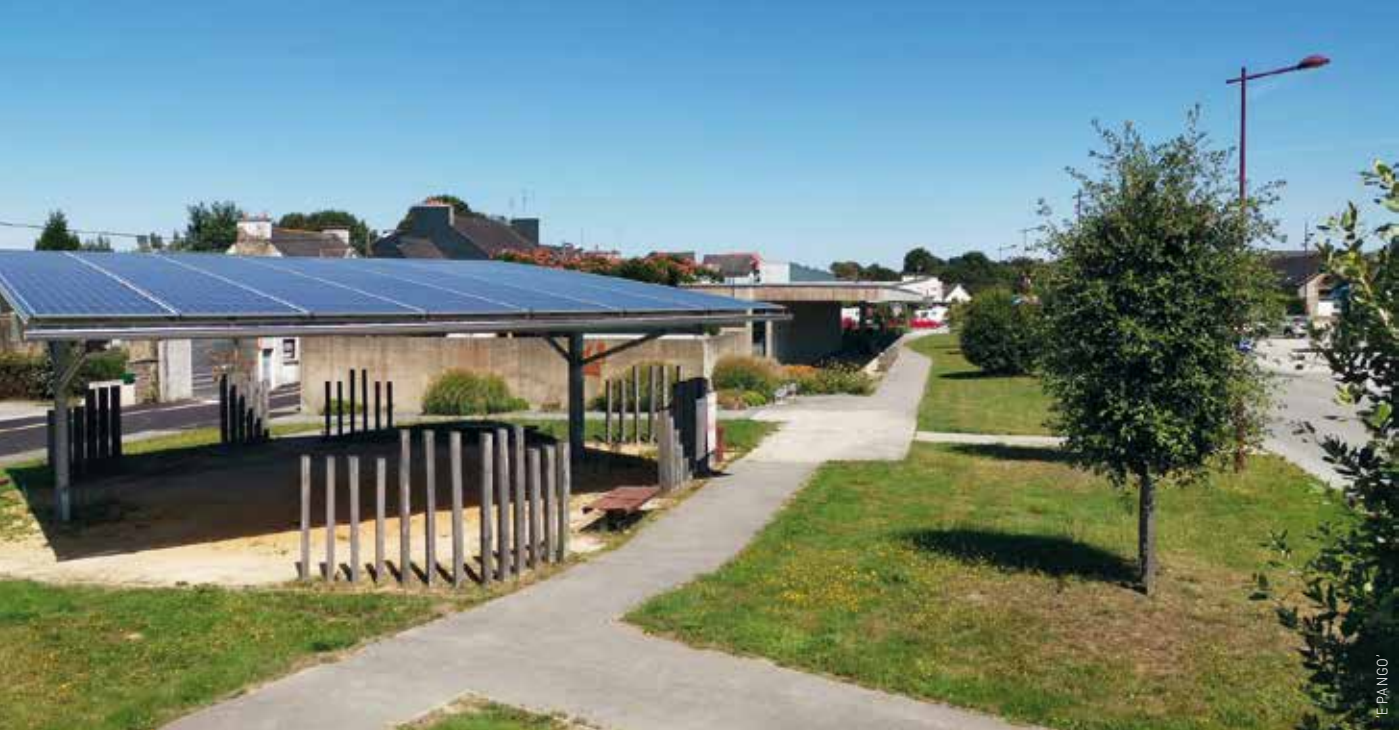
Installation d'autoconsommation en ombrière sur le parking à vélos de la médiathèque de Locminé, dans le Morbihan.
